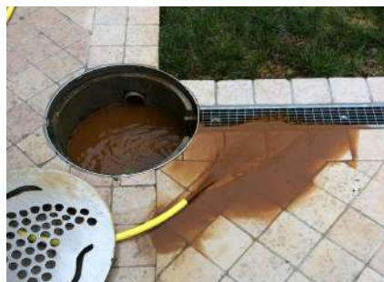
L'état de l'eau de chauffage sans protection lors d'un désembouage
